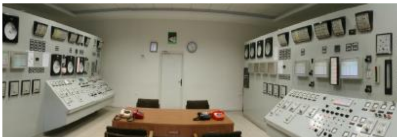
نمایی از اتاق فرمان واحدهای ۳۷/۵ مگاواتی نیروگاه اصفهان
